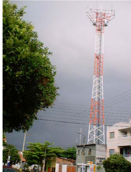
b) Estación base Real de Minas (BS2)
