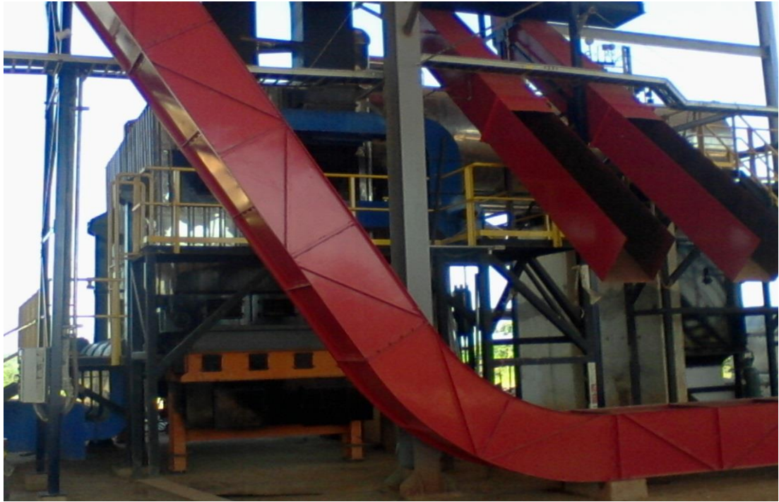
Figura 24. Caldera de generación de vapor
