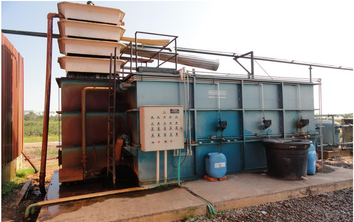
Figura 25. Planta de Tratamiento de agua
