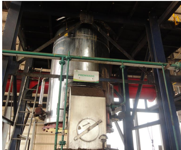
Figura 12. Vista General del Digestor
