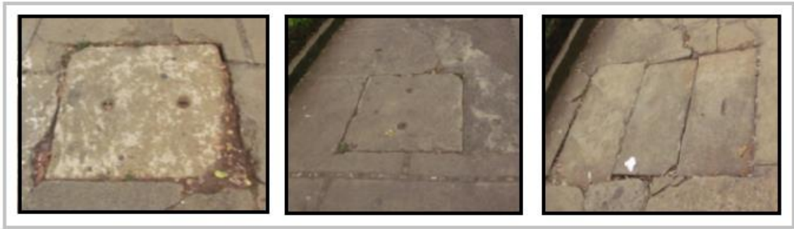
Imagen 46. Imágenes De Cajas de Inspección.
