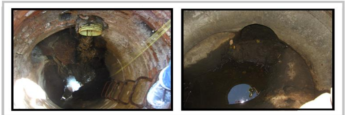
Imagen 41. Pozos en mal estado.
