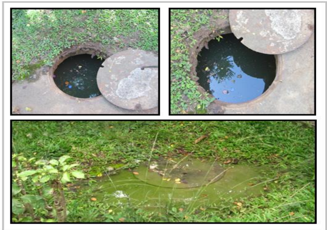
Imagen 47 Pozo Inundado en Desagüe Lago.
