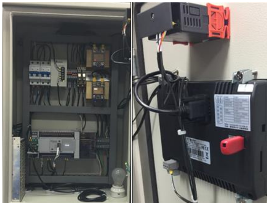
Figura 66. Tablero de control
