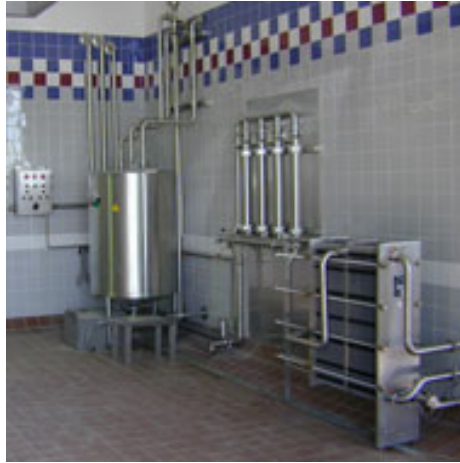
Figura 26 . Equipo para CIP para limpieza
