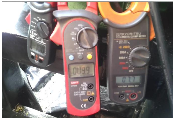
Figura 55. Pinzas amperimétrica para medir la corriente de las 3 fases del motor Fuente. Autores
