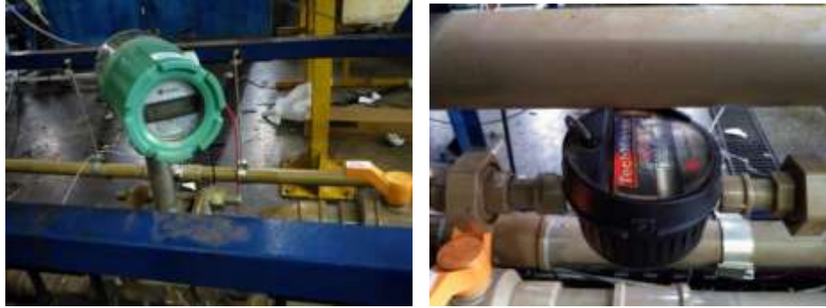
Figura 13. Medidores de caudal del agua: a) Alto caudal; b) Bajo caudal.
