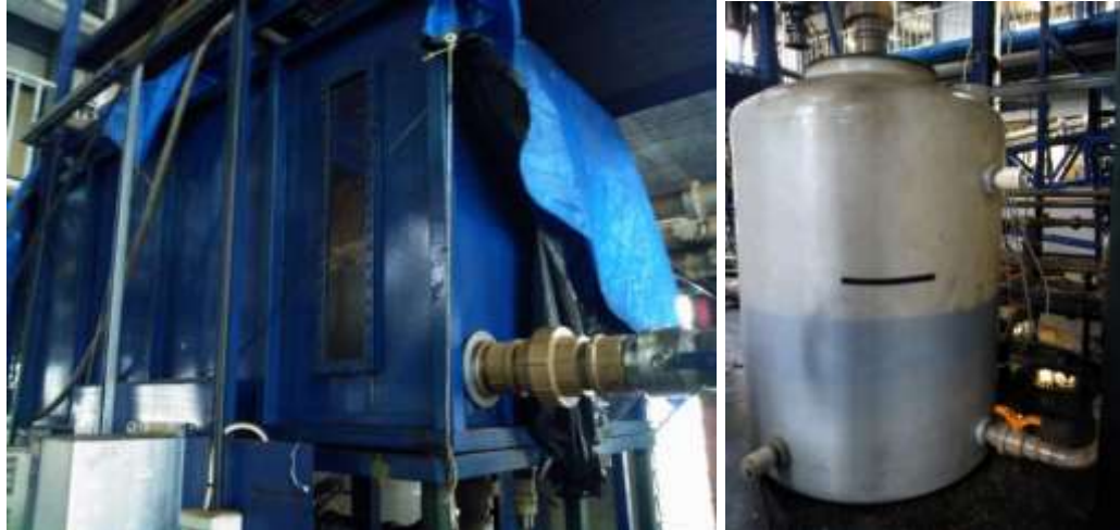
Figura 12. a) Separador de agua y aceite del tipo placas coalescentes, b) Tanque de almacenamiento de almacenamiento
