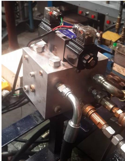
Figura 69. Manifold instalado en el banco de “La Pluma”
