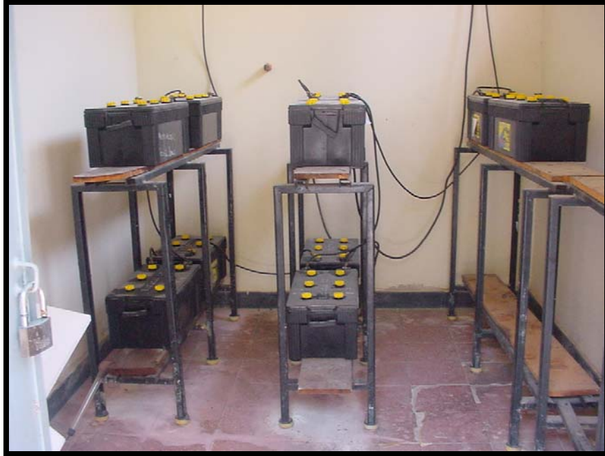
Figura 58. Banco de Baterías
