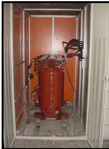
Figura 55. Transformadores secos Sistema de Servicios Auxiliares Alterna
