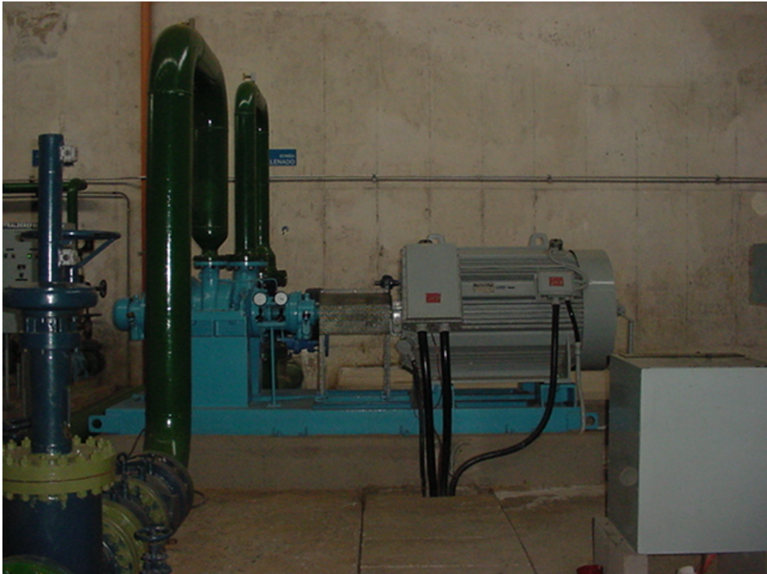
Figura 3. Vista General Unidad de Llenado
