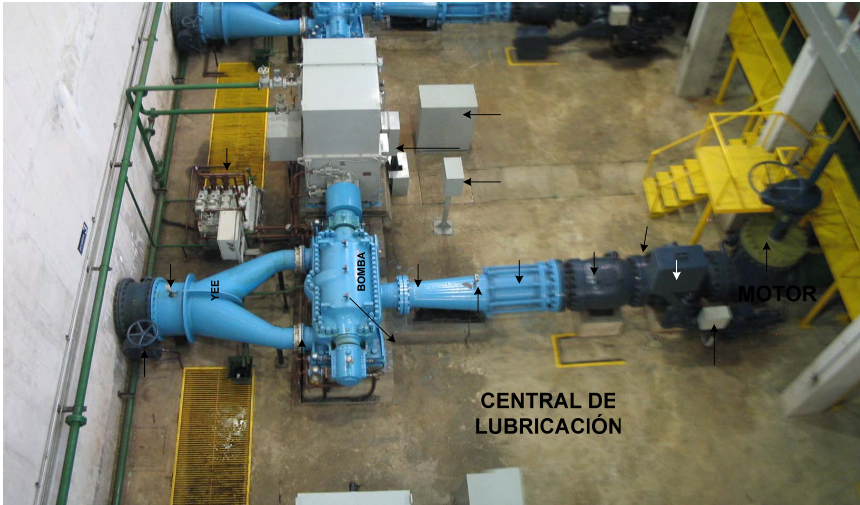
Figura 1. Vista general de la unidad de bombeo
