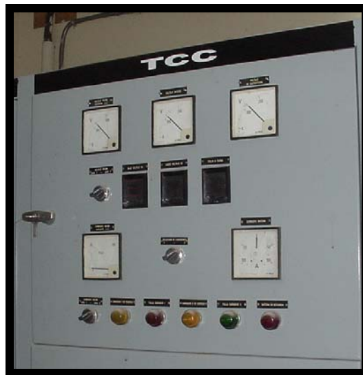
Figura 59. Tablero de mando Cargador de Baterías
