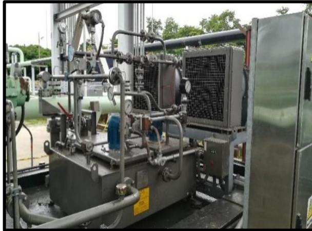
Figura 5. Sistema de lubricación en las bombas de inyección de la PIA
