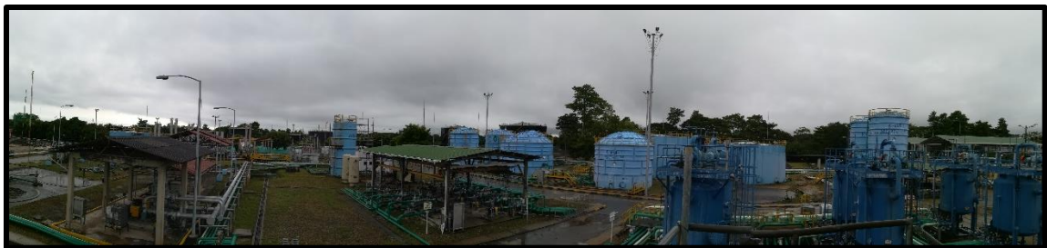
Figura 1. Planta de inyección de agua (PIA)
