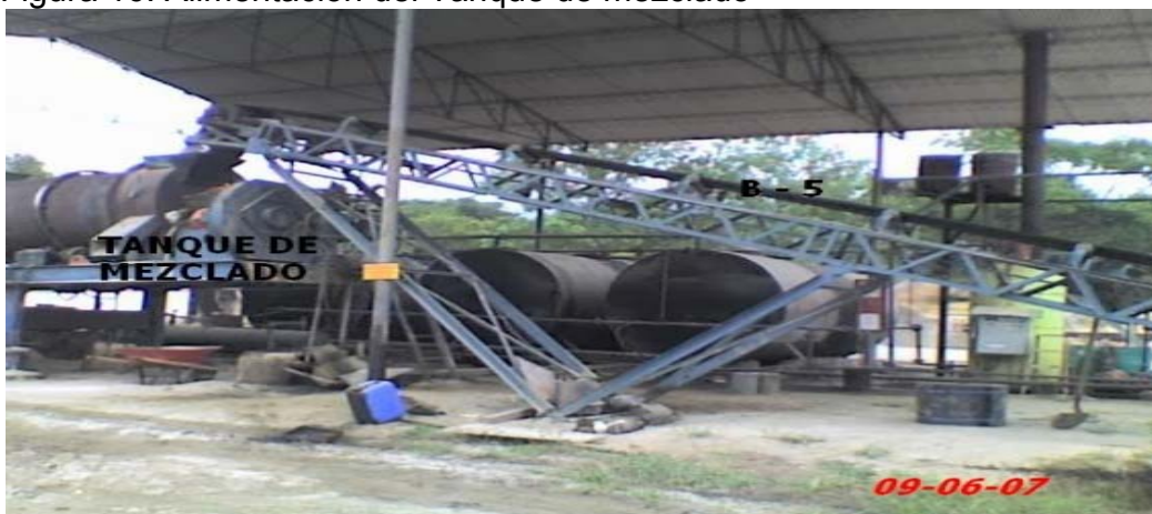
Planta de mezclas asfáltica de TECNOPAVIMENTOS
