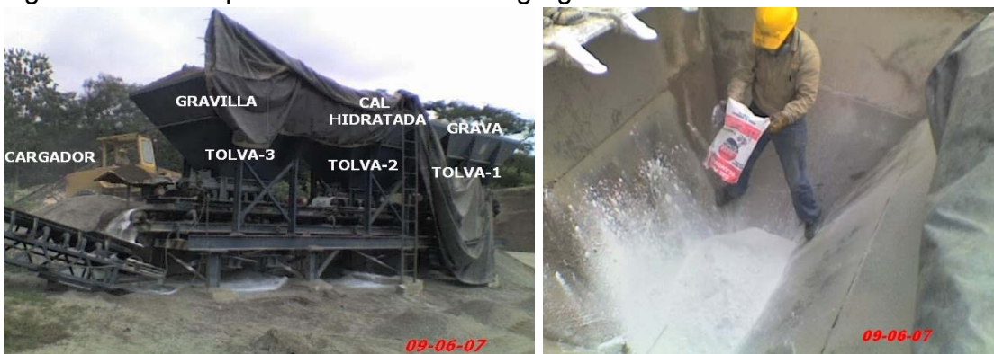
Planta de mezclas asfálticas de TECNOPAVIMENTOS
