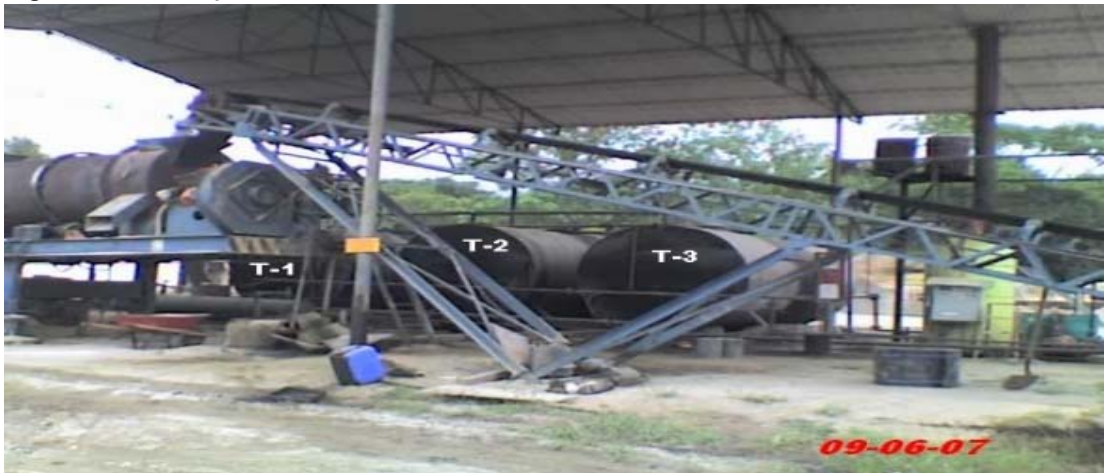
Planta de mezclas asfálticas de TECNOPAVIMENTOS
