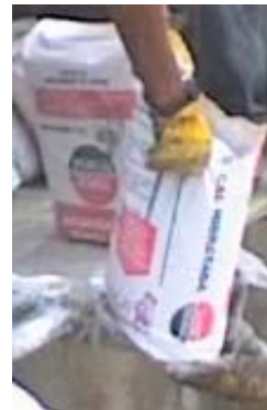
Abastecimiento tolva de alimentación
