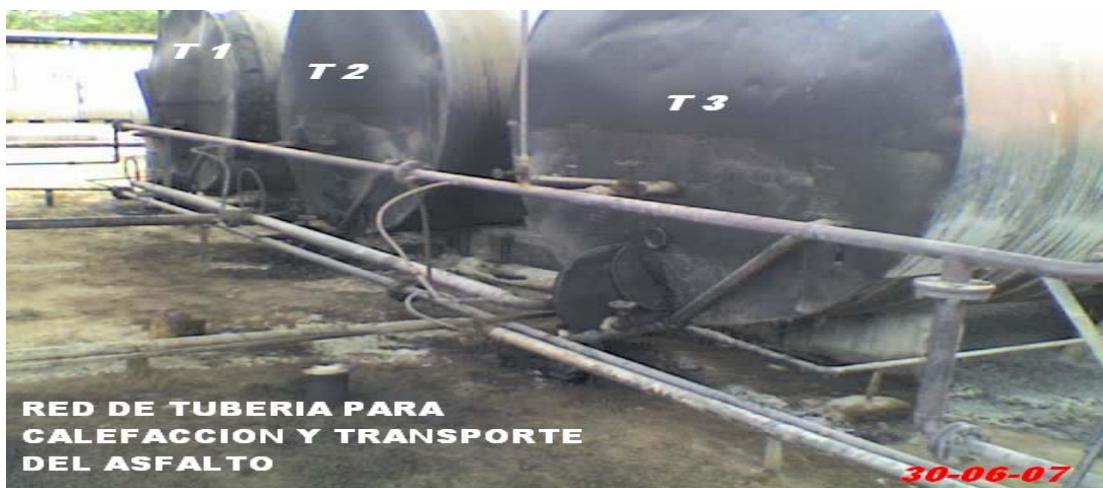
Planta de mezclas asfáltica de TECNOPAVIMENTOS
