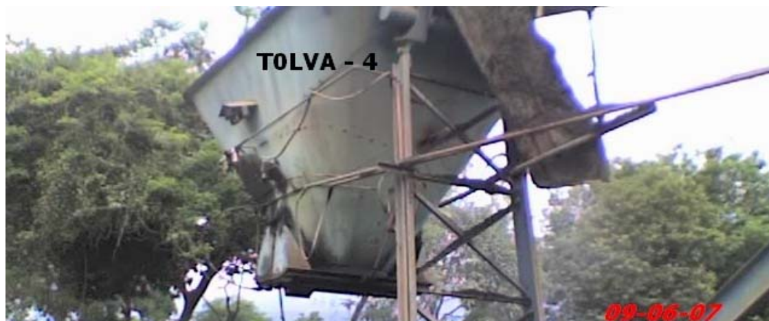
Figura 21. Tolva de almacenamiento de mezcla asfáltica
