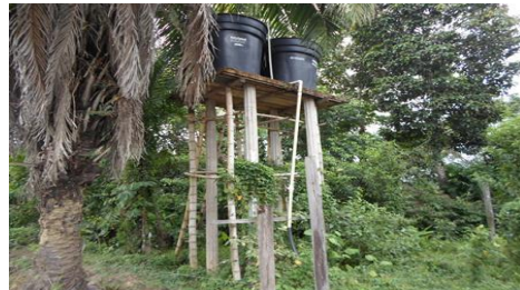
Ilustración 3 Tanques de Almacenamiento FUENTE: Los Autores
