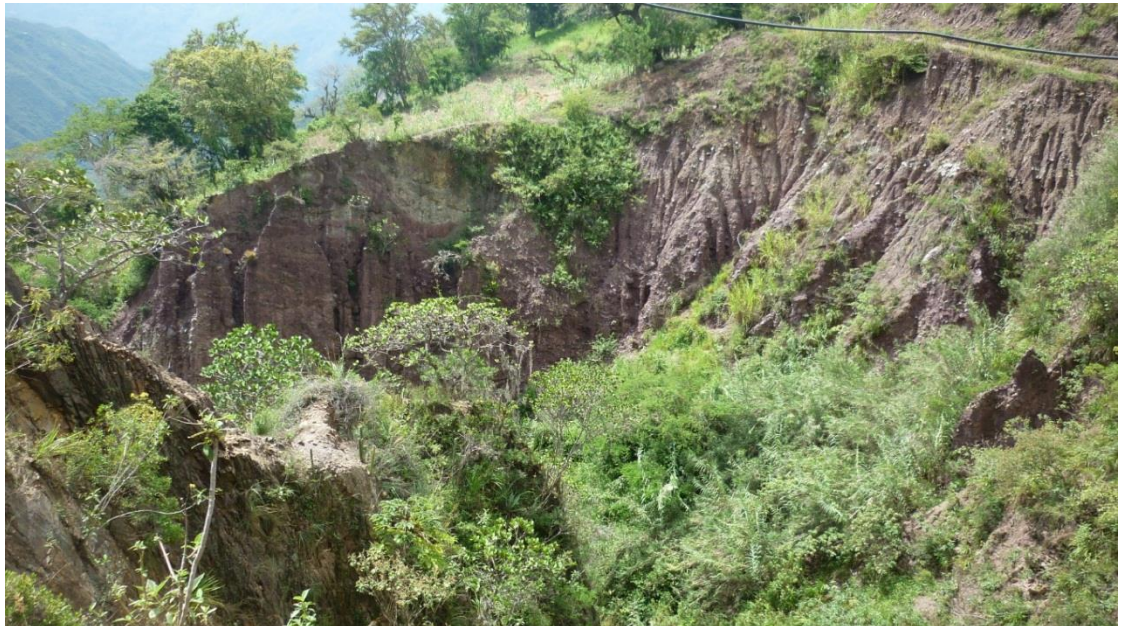
Imagen 59. Área con erosión extrema ubicada en la Parte Baja, Microcuenca Tabarlaque. Coordenadas 1146511.08 Este y 1220181.40 Norte
