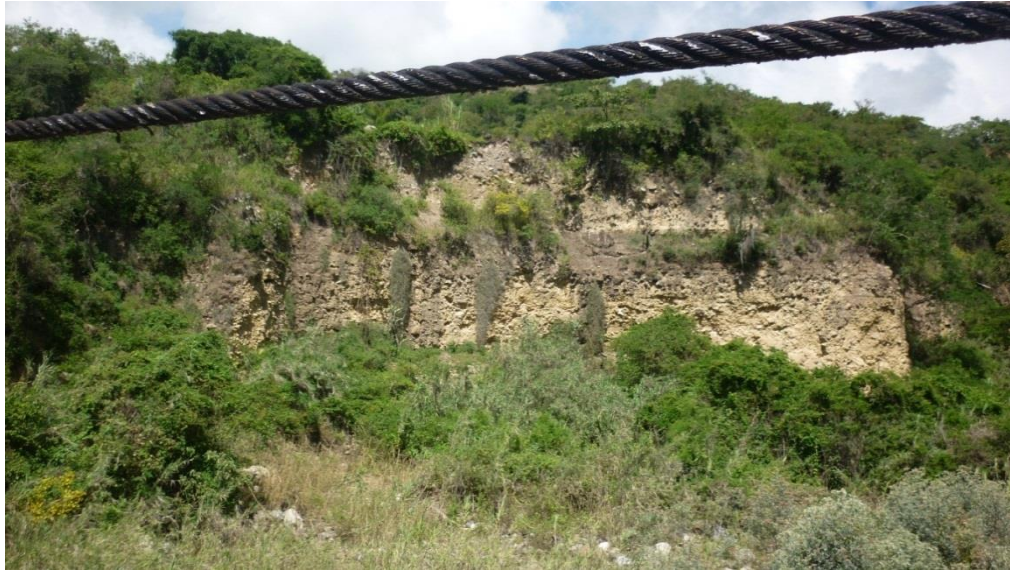
Imagen 52. Área con erosión extrema ubicada en la Parte Baja, Microcuenca Los Cojos. Coordenadas 1149154.01 Este y 1229093.31 Norte
