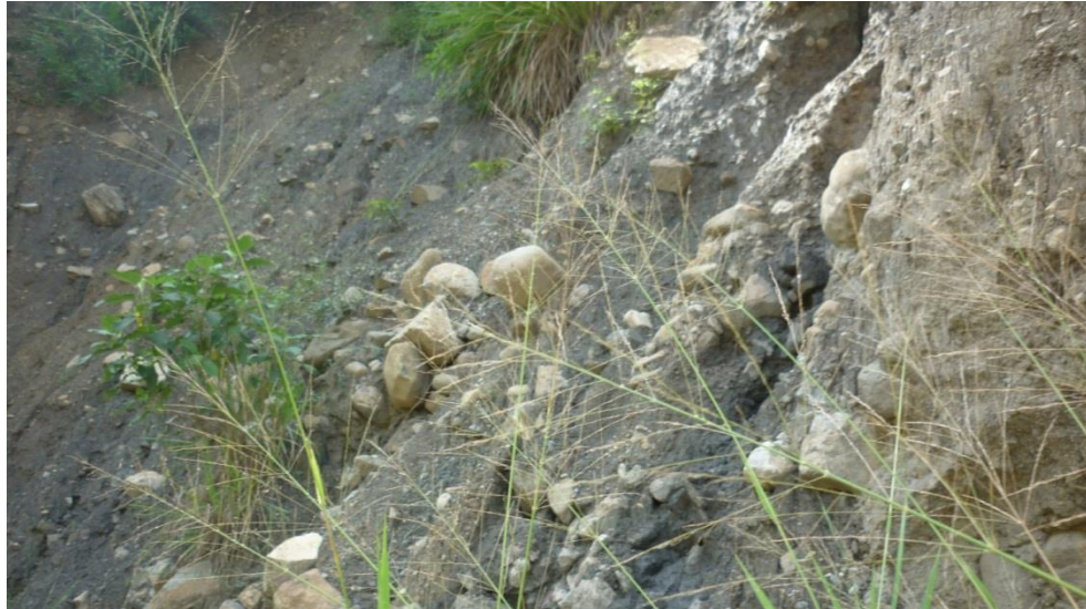
Imagen 54. Área con erosión extrema ubicada en la Parte Media, Microcuenca Popagá. Coordenadas 1149636.94 Este y 1227792.65 Norte
