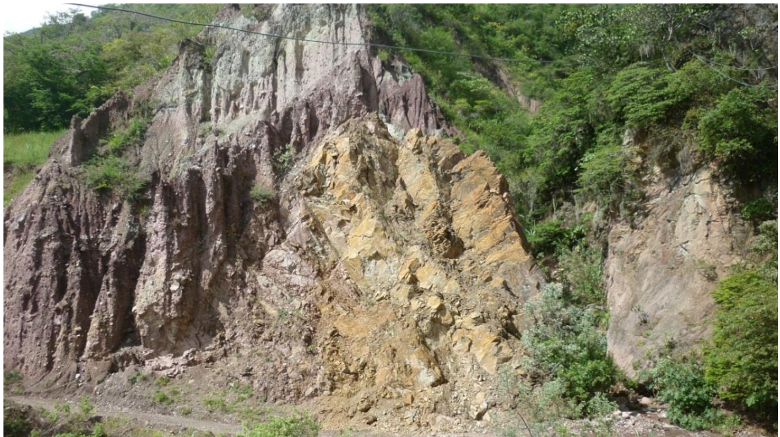
Imagen 57. Área con erosión extrema ubicada en la Parte Media, Microcuenca Tabarlaque. Coordenadas 1147174.86 Este y 1223209.88 Norte
