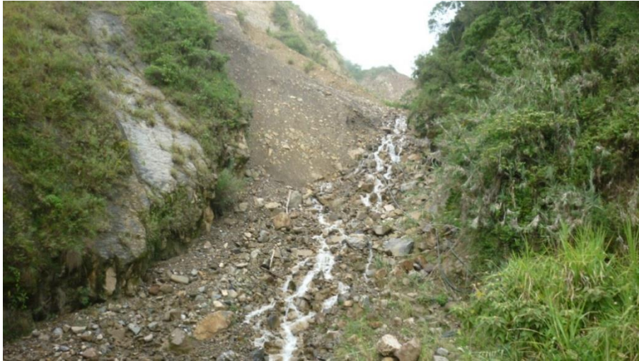
Imagen 48. Área con erosión extrema ubicada en la Parte Media, Microcuenca Los Cojos. Coordenadas 1148037.06 Este y 1228799.12 Norte
