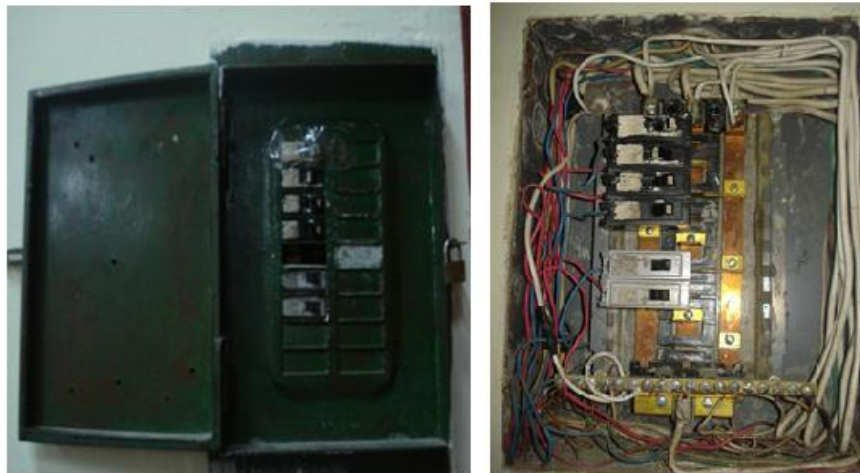
Figura 19. Fotografía del Tablero TC.
