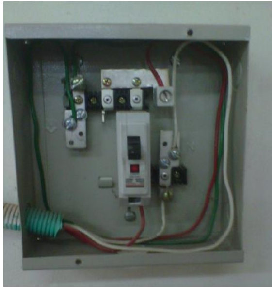
Figura 22. Fotografía del Tablero TF.
