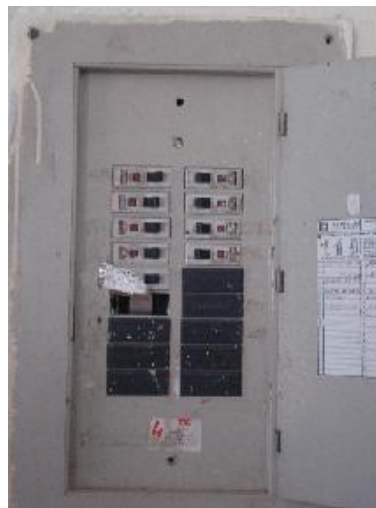
Figura 28. Fotografía del Tablero TL.
