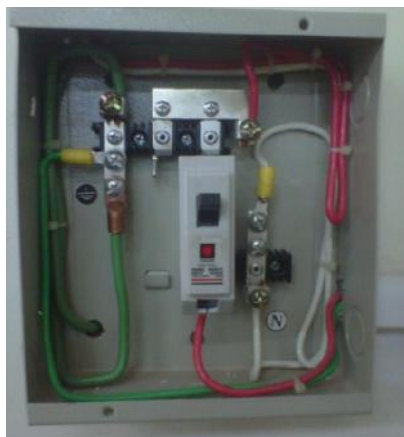
Figura 21. Fotografía del Tablero TE.
