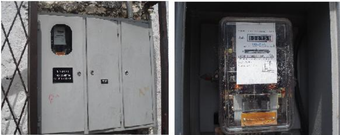
Figura 12. Fotografía del Medidor.
