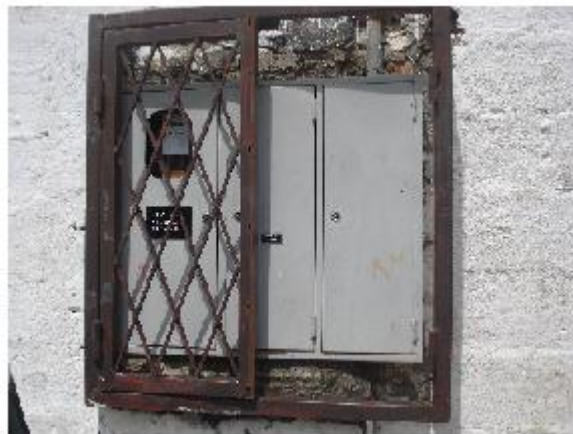
Figura 13. Fotografía del Tablero TMT.
