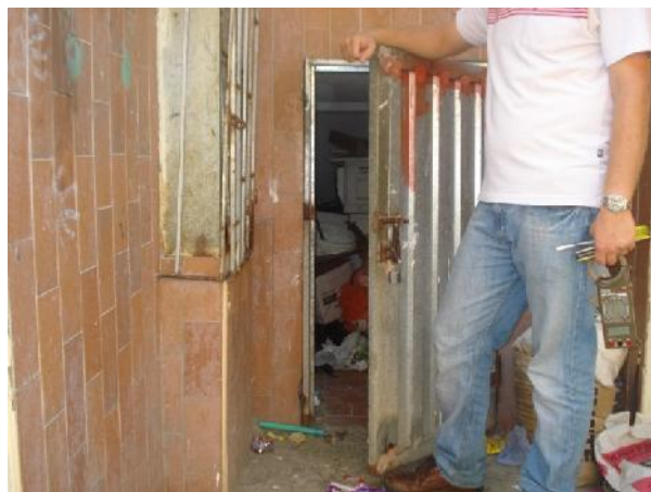
Figura 17. Cuarto de Tableros TA y TB.
