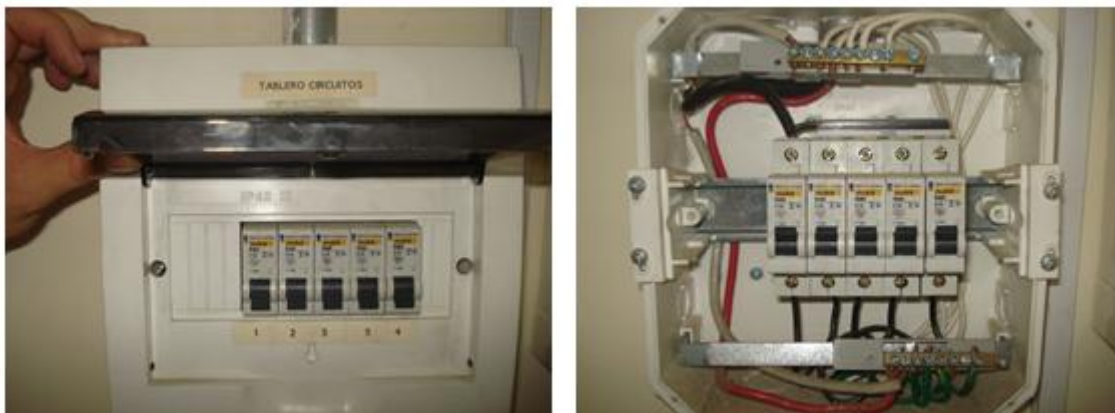
Figura 27. Fotografía del Tablero TK.
