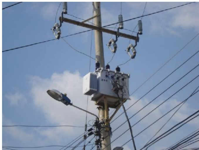
Figura 10. Transformador de Potencia de 45kVA-Trifasico.
