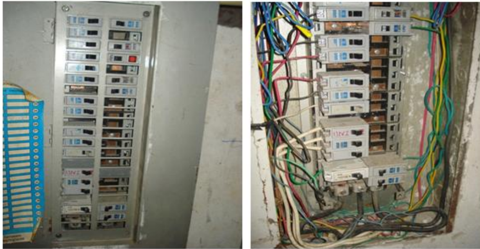
Figura 15. Fotografía del Tablero A.
