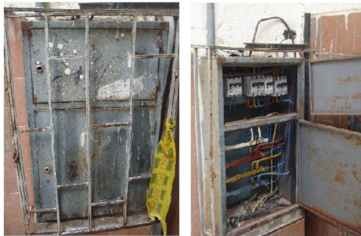
Figura 14. Fotografía Tablero TGD.
