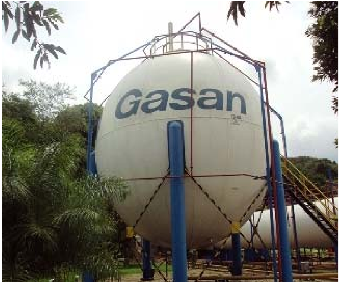
Figura 14. Planta principal de envasado de GLP.
