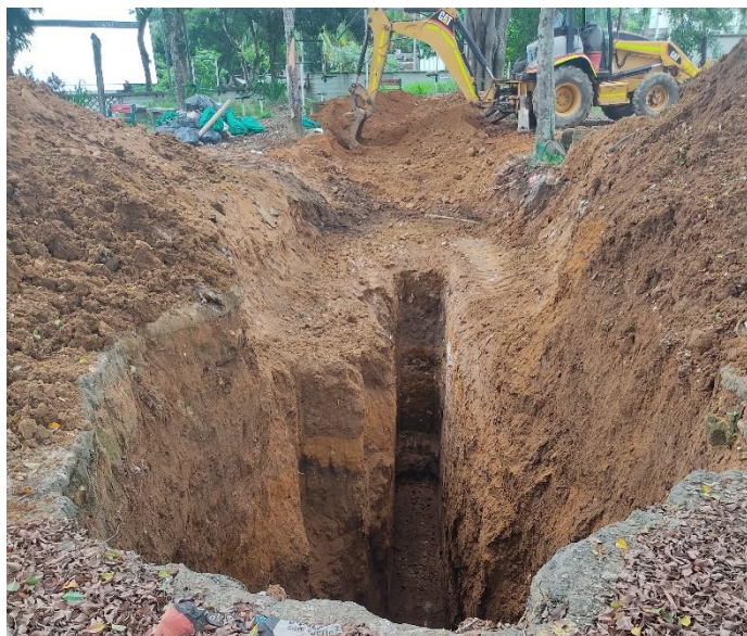
Figura 5. Tubería principal de la red de alcantarillado
