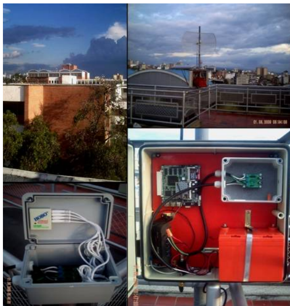
Figura 1.1 Instalación y ubicación del nodo de pruebas dentro de la Universidad Industrial de Santander.
