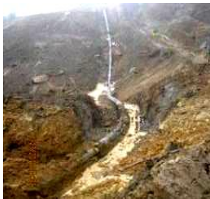
Foto 14. Deformación de la tubería de un oleoducto
