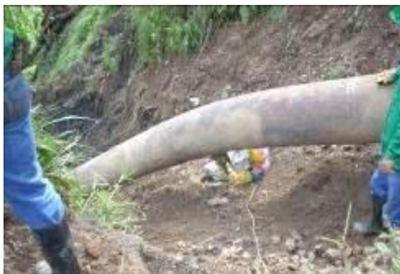
Foto 19. Estado de alineamiento de la tubería al retirar la carga del terreno, caso de estudio 1
