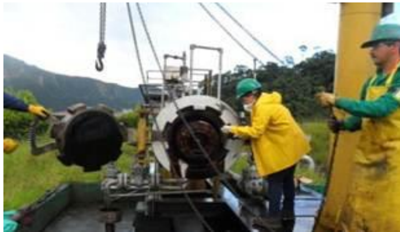
Foto 6. Toma de muestras material de arrastre de raspadores en la evaluación de la pérdida de metal corrosión interna.
