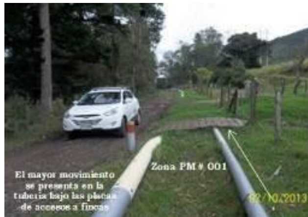
Foto 18. Estado de afectación de los ductos aéreos cuando se construyen estructuras de accesos sobre estos
