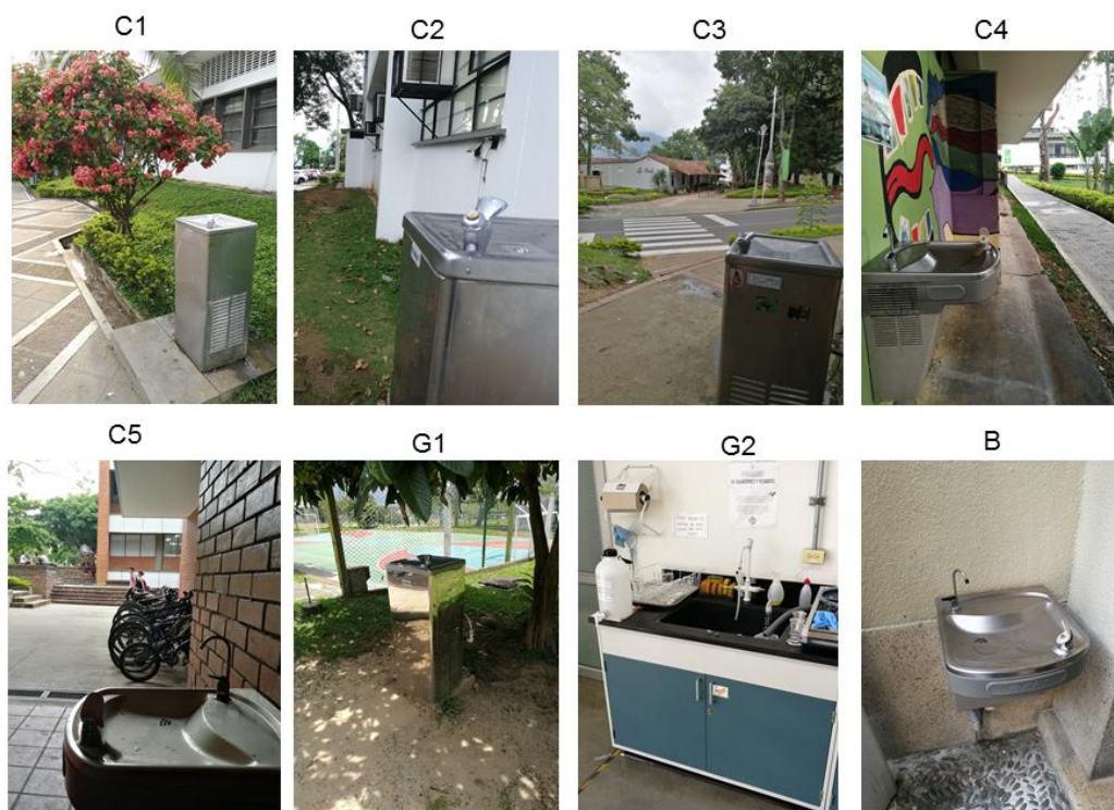
Figura 3. Fotografías del estado de los bebederos y toma de agua del Laboratorio de Electroquímica ubicados en las instalaciones de la Universidad Industrial de Santander. En la figura se indica la etiqueta de los distintos bebederos y toma de agua.
