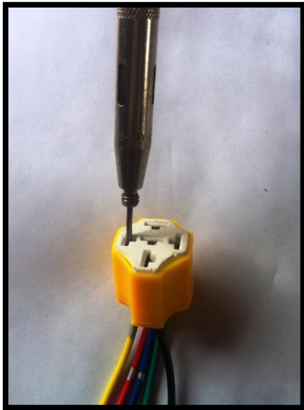
Imagen. Prueba de Señal de START al RELE. Fuente. Propia.
