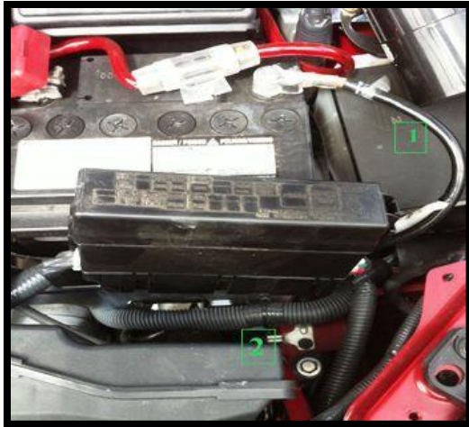
Imagen. Cables de Masa. Fuente. Propia.
