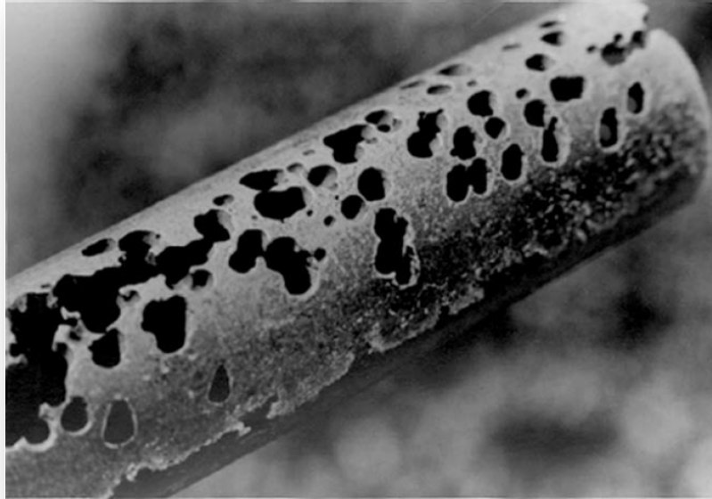
Figura 1. Tubería severamente corroída debido a presencia de bacterias sulfato-reductoras (BSR).
