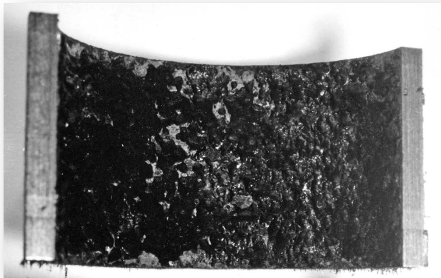
Figura 11. Depósitos de Manganeso sobre la superficie interna de una tubería.
