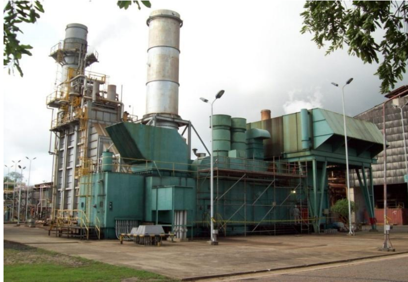
Foto N° 6. Turbogenerador TG2961 ubicado en la unidad de Balance.
