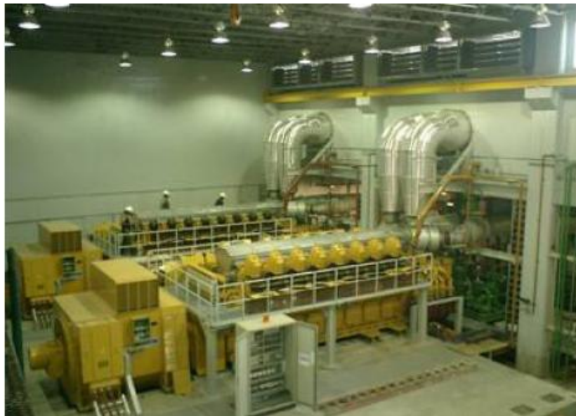
Foto N° 8. Planta de cogeneración utilizando motores a gas como driver principal.
