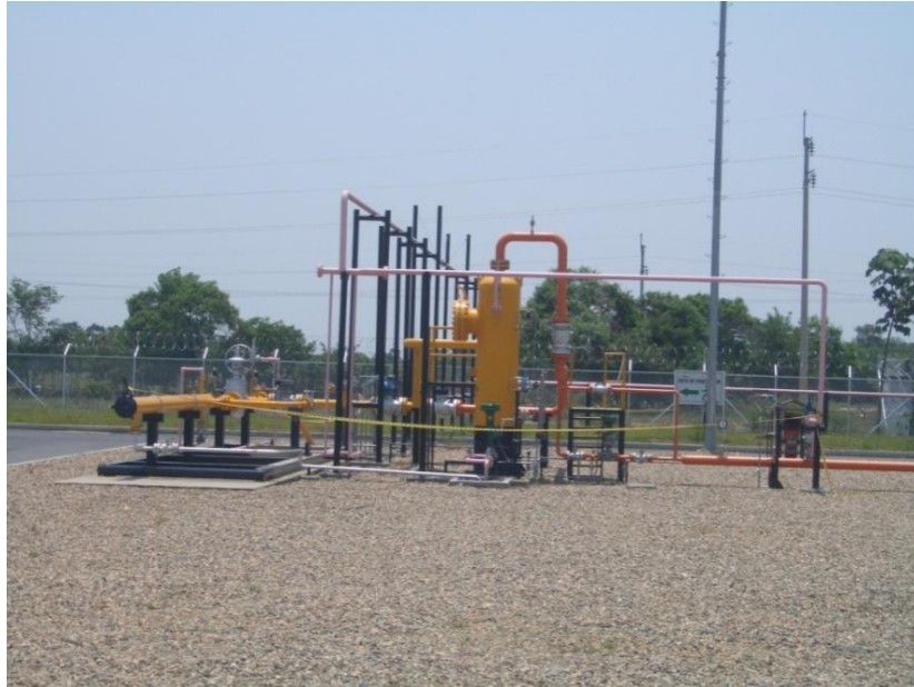
Foto N° 7. Sistema de entrada de alimentación de gas a la GRB.
