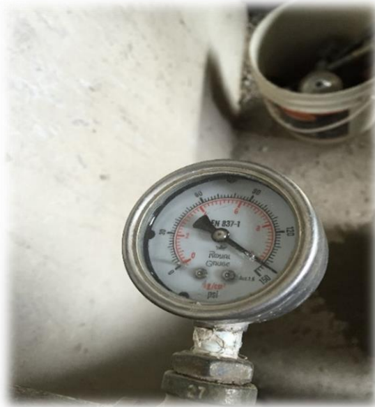
Figura 6. Manómetro registrando la presión establecida para las pruebas de presión hidráulica.
