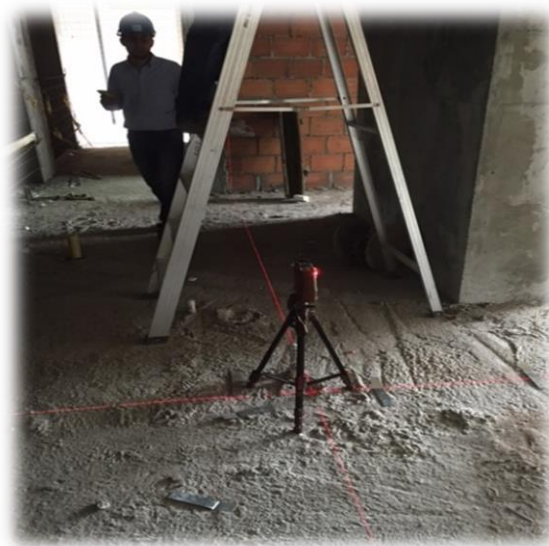
Figura 19. Nivel laser en funcionamiento para el trazado de cimbra en el interior de la edificación.
