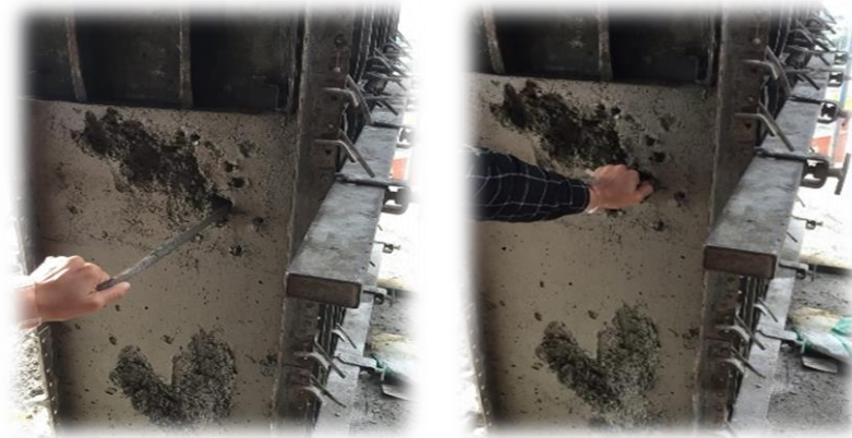
Figura. 25. Estado del concreto utilizado para las 4 columnas después de 24 horas de fraguado.
