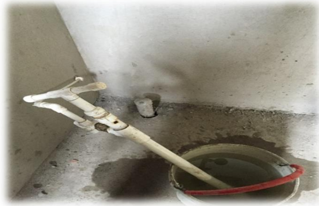
Figura 5. Bomba manual y balde con agua para el llenado de la tubería a probar.
