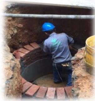
Figura 12. Excavación del primer pozo e instalación de la tubería de descole del alcantarillado aguas negras.
