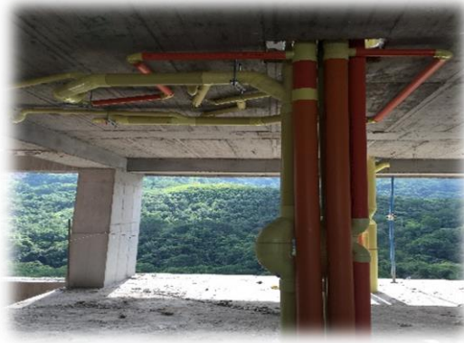
Figura 7. Puntos sanitarios conectados correctamente a los bajantes principales.
