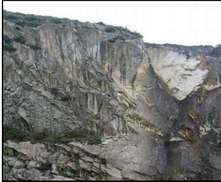
Fotografía 12. Rotura por cuña de un talud rocoso
