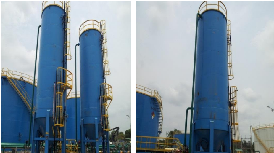
Figura 53. Decantadores DE-3091/92 PIA-3.
