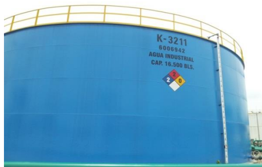
Figura 45. Tanque K-3211 de Agua Filtrada.
