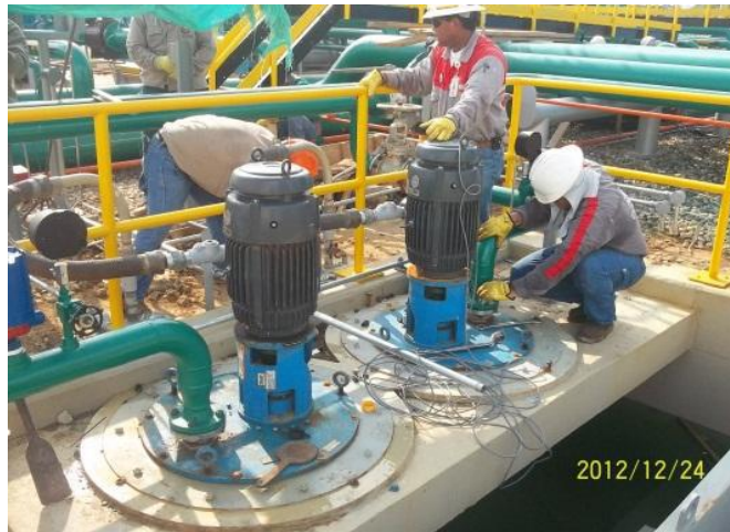
Figura 57. Bombas verticales agua a reproceso, P-3038/39
