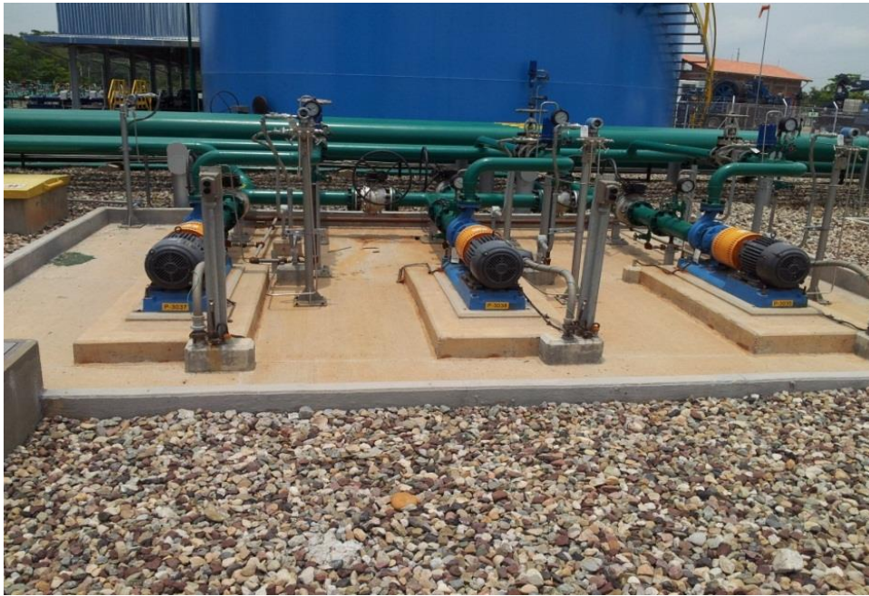
Figura 56. Bombas de agua a reproceso P-3035/36/37.
