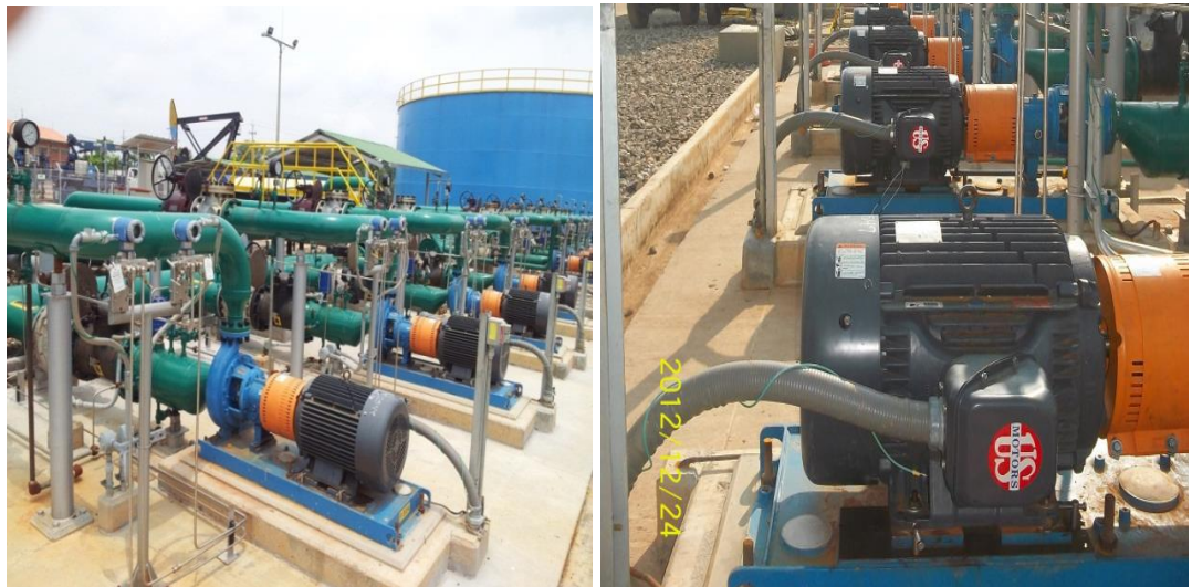
Figura 41. Bombas P-3031/32/33/34 carga a filtros cascara de nuez.
