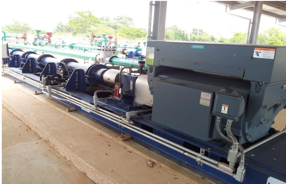
Figura 49. Bomba Centrifuga Inyección de Agua – PIA3.
