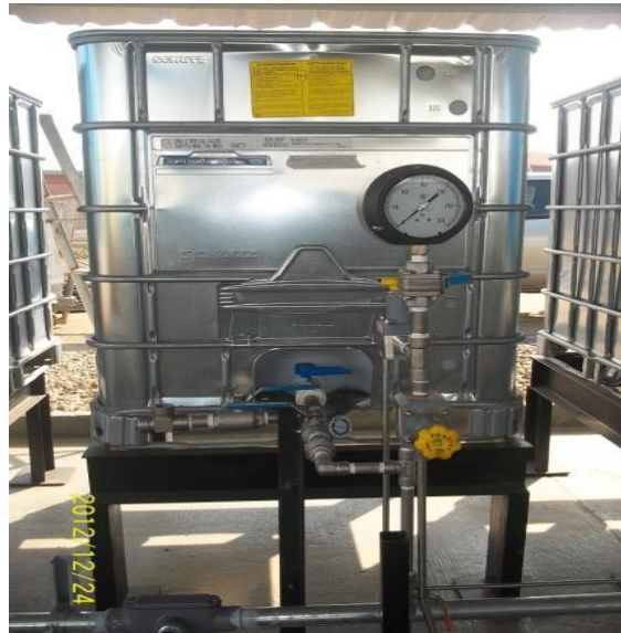
Figura 55. Conexión Para Inyección De Floculante PIA-3
