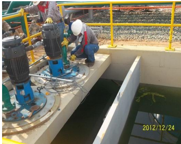
Figura 58. Caja de lodos y bombas de reproceso PIA3.
