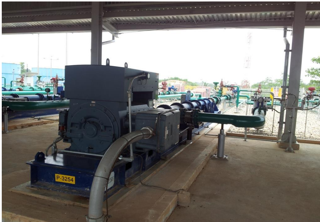
Figura 51. Bomba Centrifuga Inyección de Agua – PIA3.
