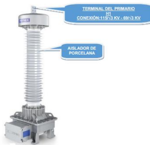
Figura 48. Transformador de potencial subestación WEG
