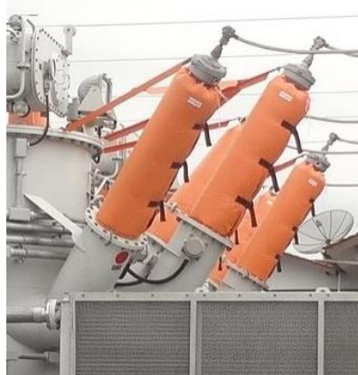
Figura 28. Transformadores de Corriente subestación WEG
