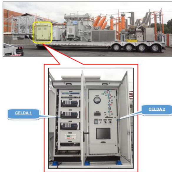
Figura 51. Celdas de protección y control de la subestación WEG
