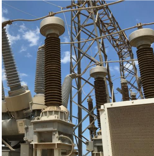
Figura 29. Transformadores de potencial de la subestación WEG
