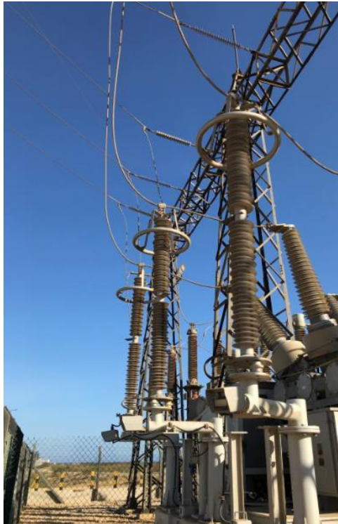
Figura 41. Pararrayos subestación WEG
