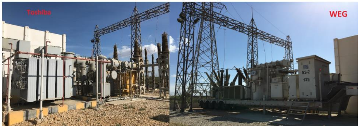
Figura 12. Subestaciones Toshiba y WEG
