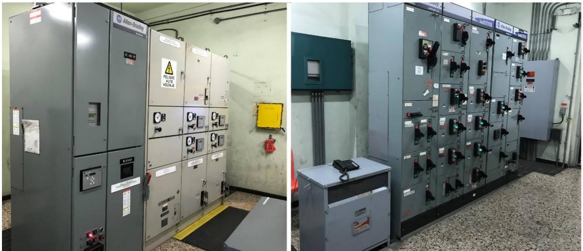
Figura 7. Interior de una subestación típica
