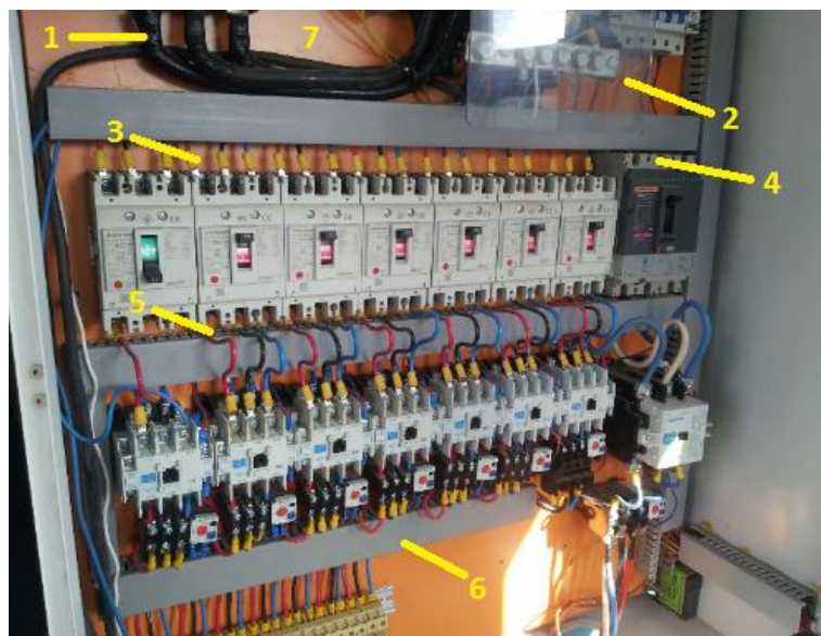
Figura.50 Foto tablero de control con puntos de medida de termografía.
