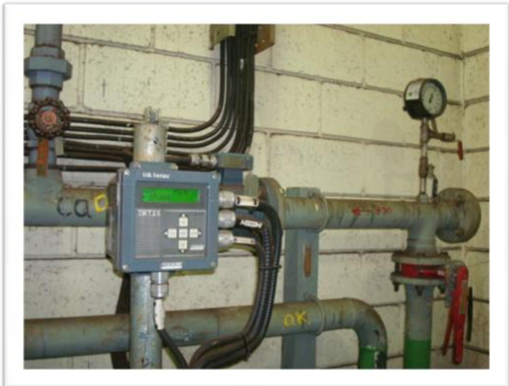
Figura 17 – Indicador Agua de Enfriamiento Transformadores
