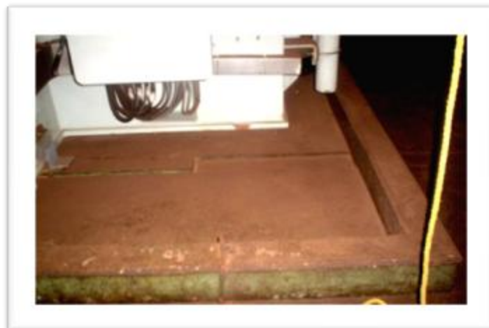
Figura 22 - Foso contenedor del transformador en caso de derrame de aceite
