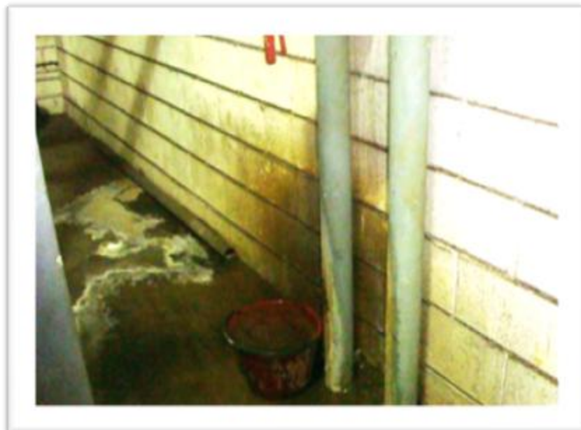
Figura 24 - Presencia de agua en el cuarto de transformadores
