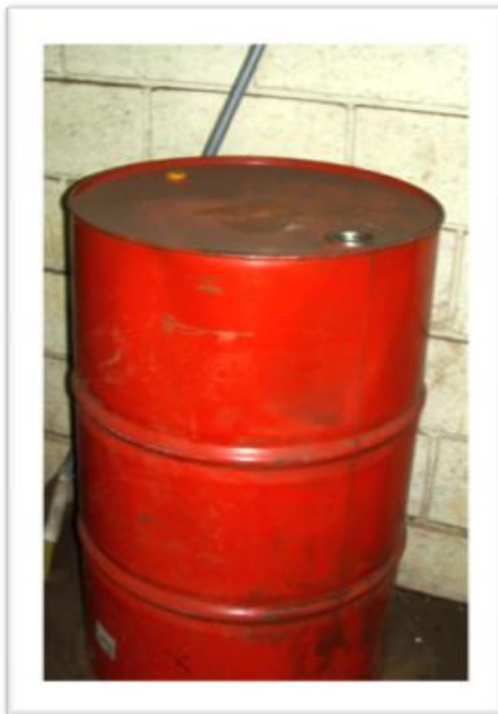
Figura 23 - Contenedor aceite del transformador
