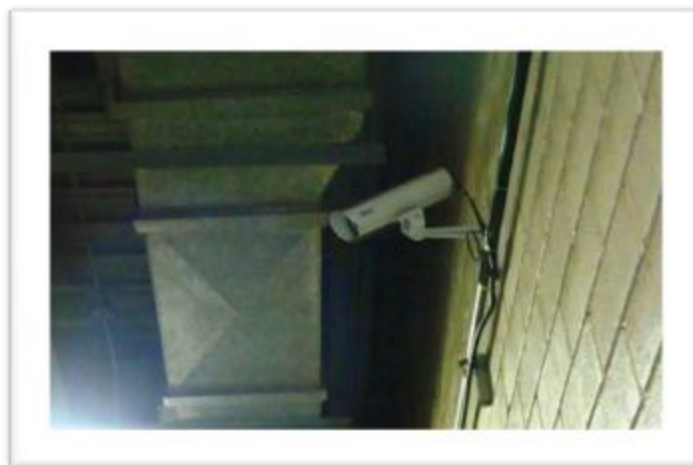
Figura 11 - Cámara de Seguridad
