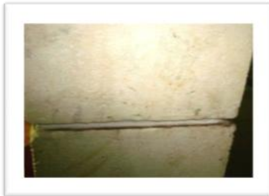
Figura 20 - Separación de los Transformadores en el cuarto de Línea 2.
