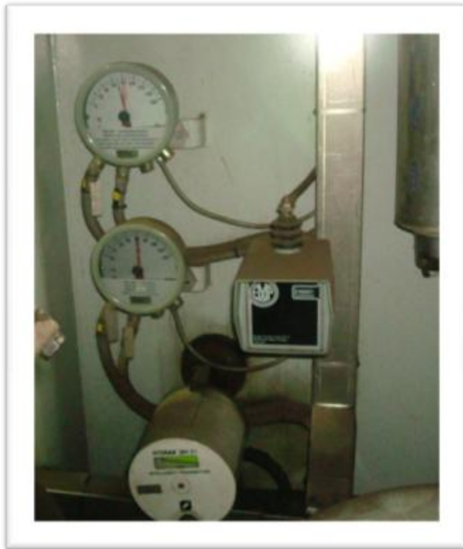
Figura 14 - Instrumentación en los transformadores
