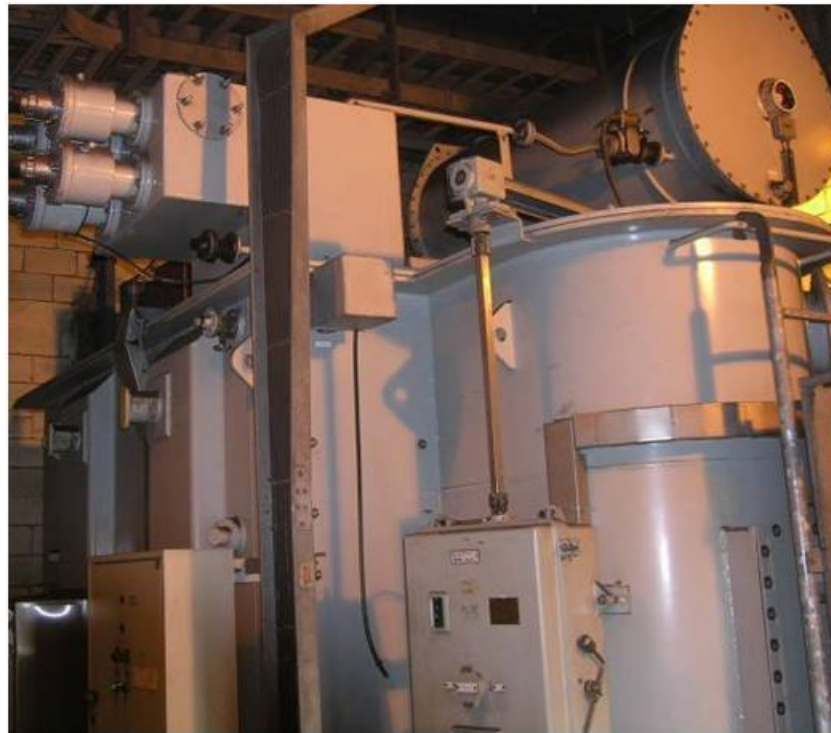
Figura 5 - Transformador Eléctrico Línea 2.
