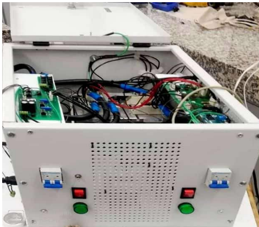
Figura 25. Ensamble de los componentes de la fuente (vista desde la parte exterior de la caja). Fuente Autores
