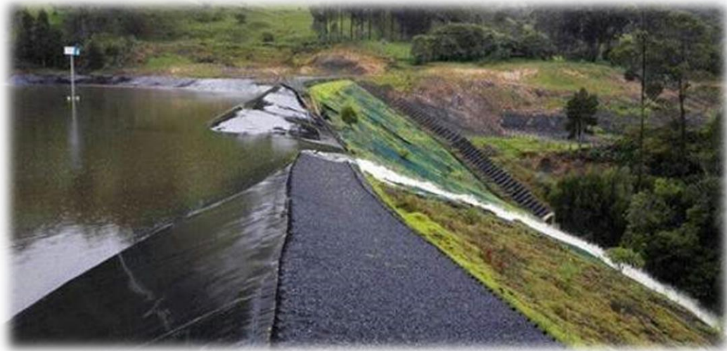
Figura 12. Represa de Vélez después del colapso.
