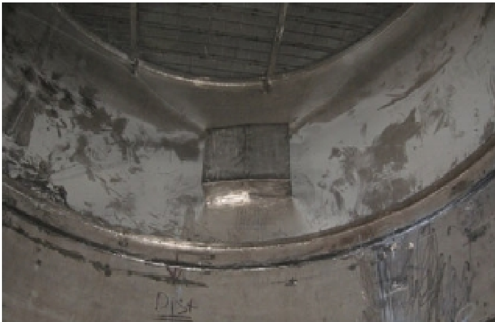
Figura 24. Recubrimiento de polvo en las paredes de la torre, septiembre de 2009
