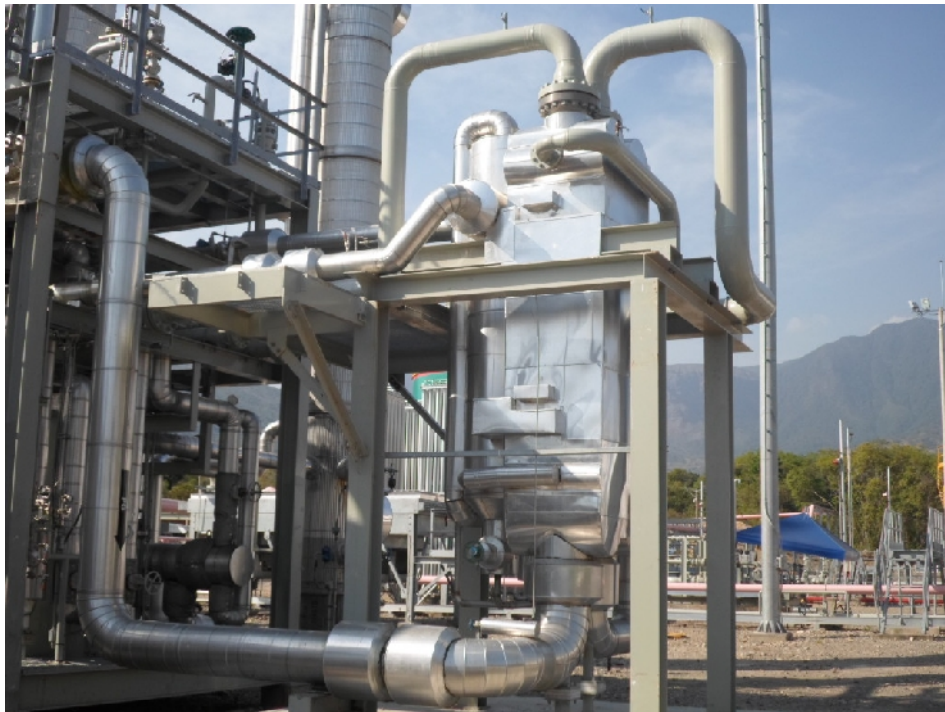
Figura 29. Intercambiador de calor de aluminio soldado de la planta en estudio E-4010/11.
