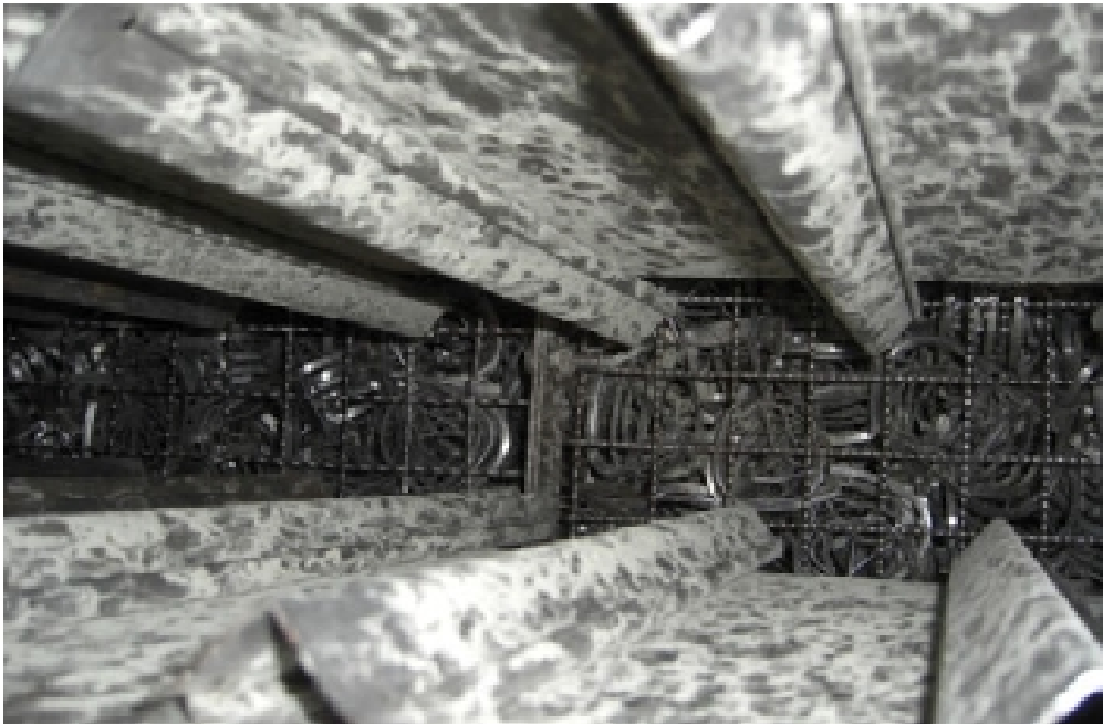
Figura 27. Polvo en distribuidores de líquido de la Torre Deetanizadora
