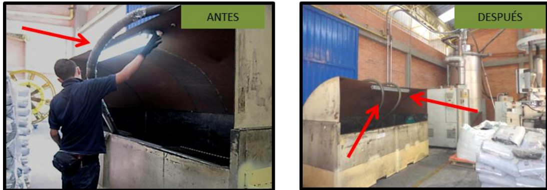
Imagen 41. Segundo ducto de succión para zona de alimentación
