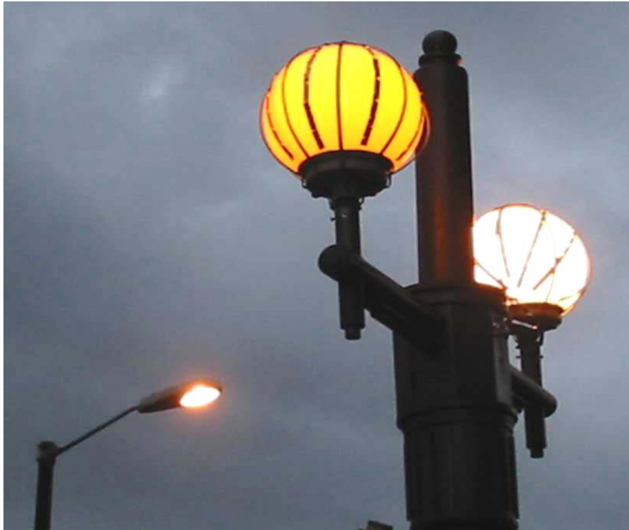
Foto 6. Luminaria Mirage-Schereder de 150W Na. - Ornamental
