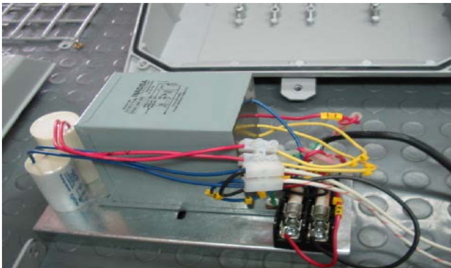
Foto 3. Conjunto electrónico de la luminaria LU005B
