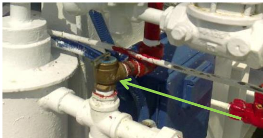
Imagen 11. Cambio de la PSV del proceso de regeneración
