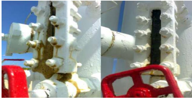
Imagen 15. Cambio indicador de nivel del sistema de filtración
