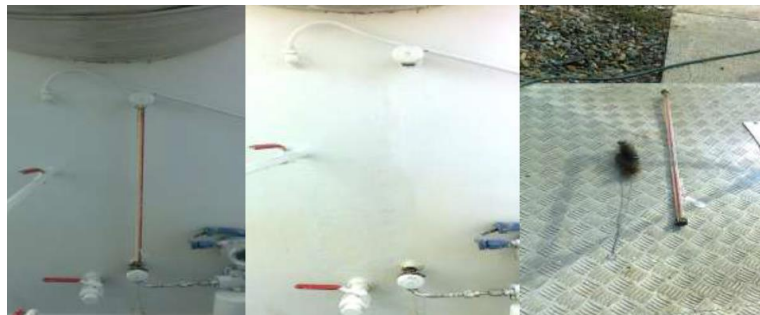
Imagen 14. Cambio indicador de nivel del proceso de regeneración
