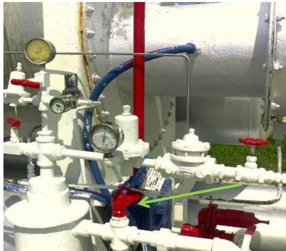
Imagen 10. Cambio de la PSV del proceso de regeneración
