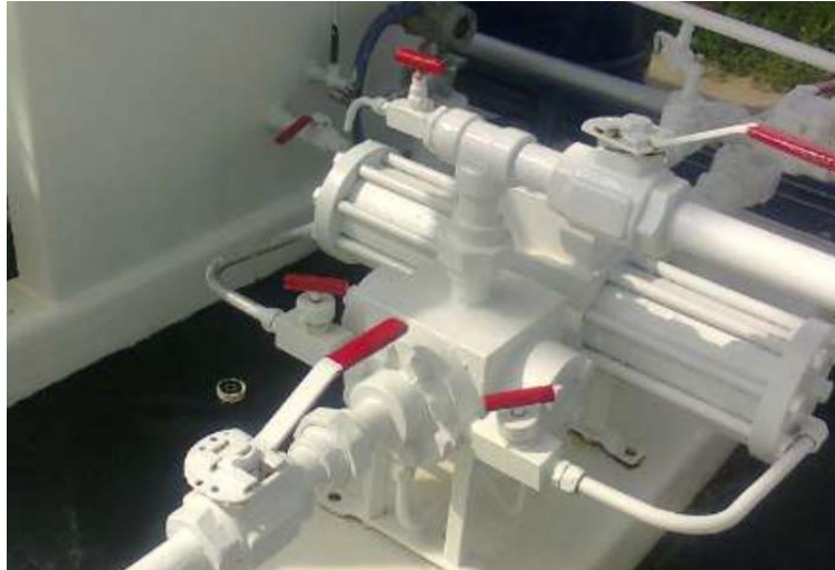
Imagen 4. Bomba de glicol
