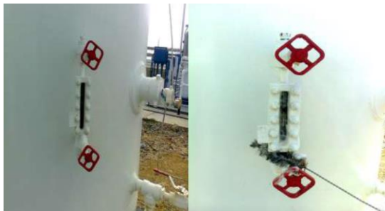
Imagen 16. Cambio indicador de nivel del scrubber
