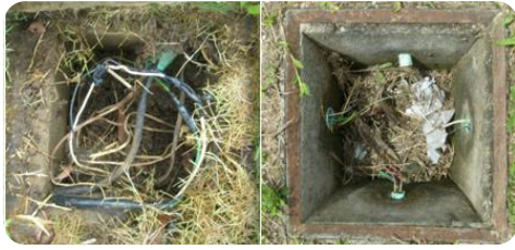
Figura 4. Cajas de paso
