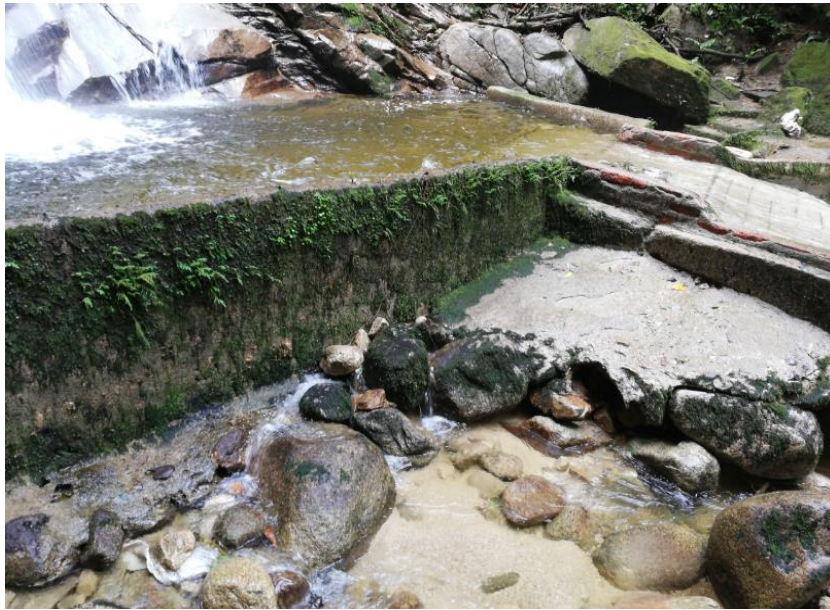
Figura 5. Detalle de filtración de agua en la parte inferior de la bocatoma del acueducto veredal CORPOAGUAS. Adaptado de IMMA S.A.S, 2019.
