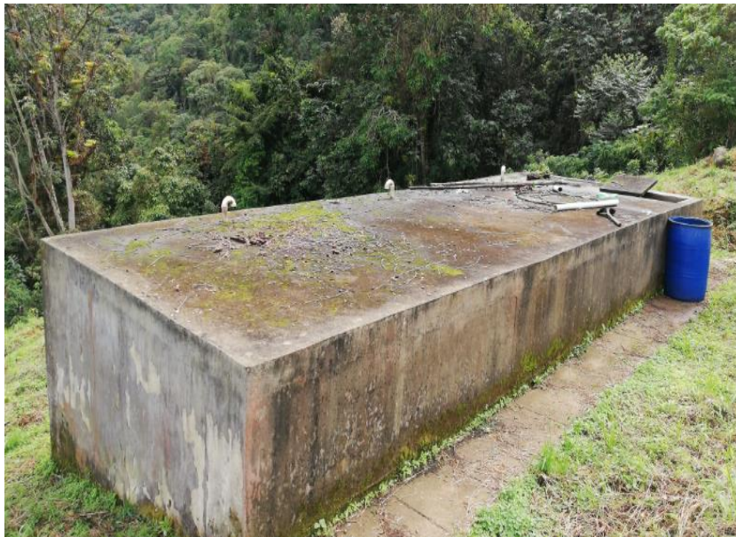
Figura 9. Tanque de almacenamiento del acueducto veredal CORPOAGUAS. Adaptada de IMMA S.A.S, 2019.
