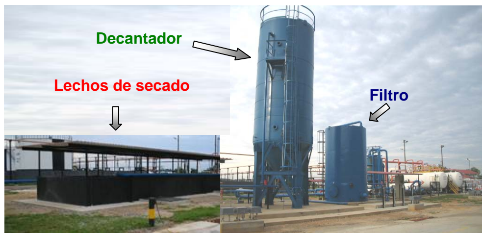
Figura 31. Piloto de reinyección de agua en la estación Suria de Ecopetrol S.A.
