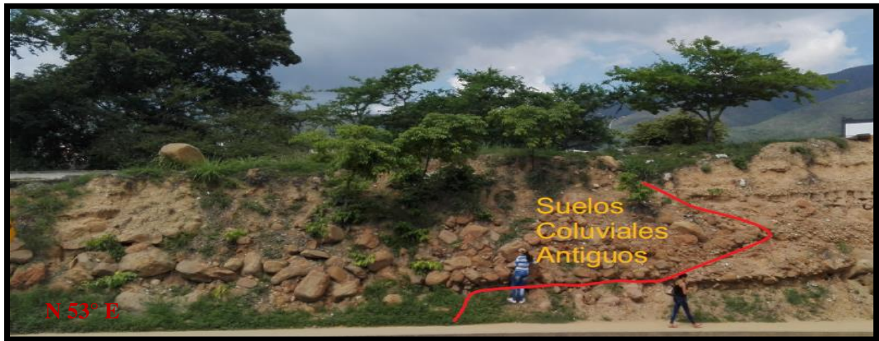
Figura 22. Suelos coluviales antiguos encontrado en el Talud y proveniente de la Formación Girón.
