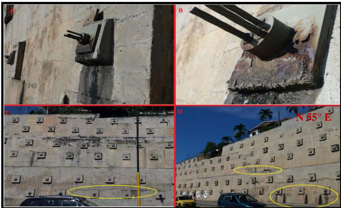
Figura 7. Deterioro del muro de cemento. Ay B: Infiltración de agua y corrosión producida. C y D: Infiltraciones generales del talud.
