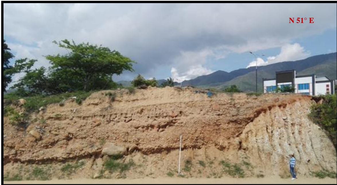
Figura 25. Laderas erosionadas y formación de tierras malas. Talud ubicado en El poblado, Girón
