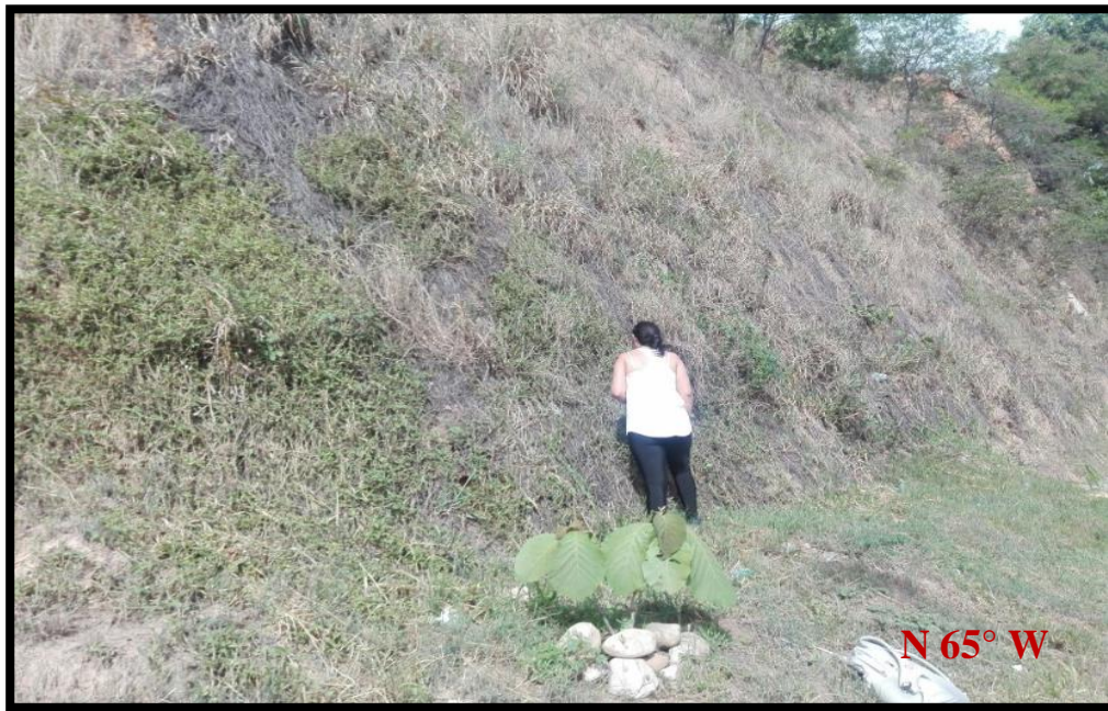
Figura 10. Estado actual de las obras que realizaron para mitigar la estabilidad del talud.
