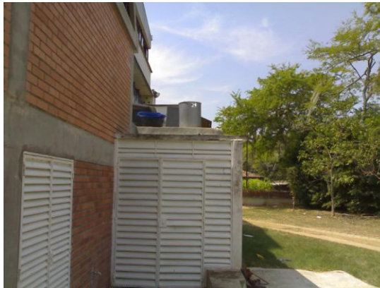
Figura 16. Caseta de recolección de los residuos de comedores.
