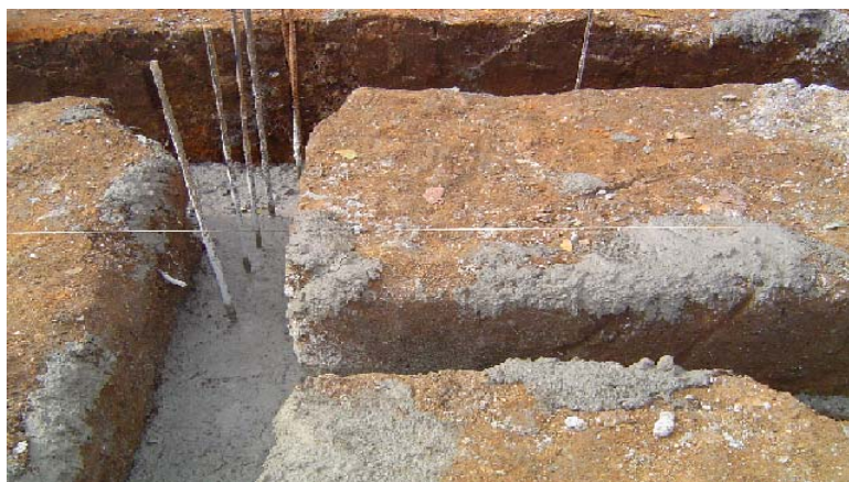
Fotografía 21: Desperdicio por el vaciado con carretilla del concreto
