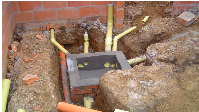
Fotografía 6: Caja de desagües
