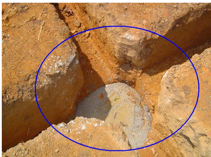
Fotografía 25: Sobreexcavación producida por los pilotes
