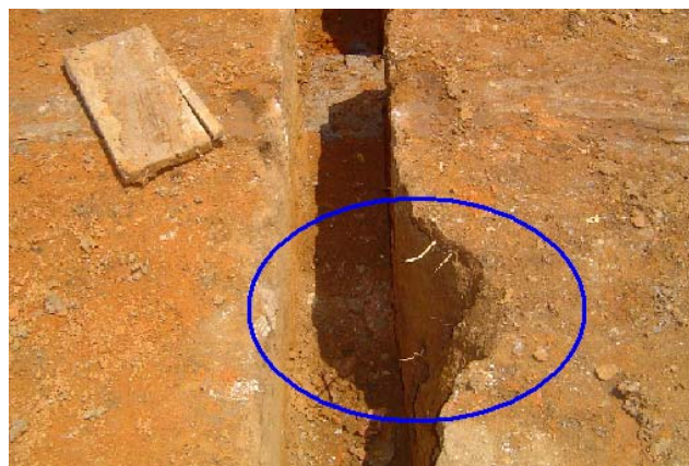
Fotografía 24: Derrumbe en la zanja de la cimentación
