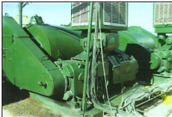
Figura 71. Motores eléctricos suministrando energía a bombas de lodo
