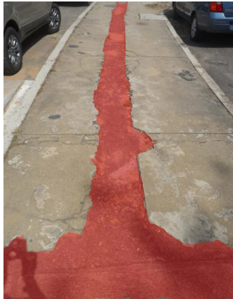
Figura 2. Problema tipo 2 andenes en mal estado
