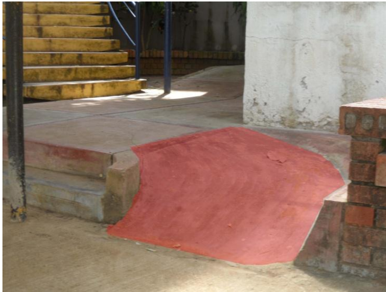
Figura 4. Problema tipo 4 rampas mal construidas
