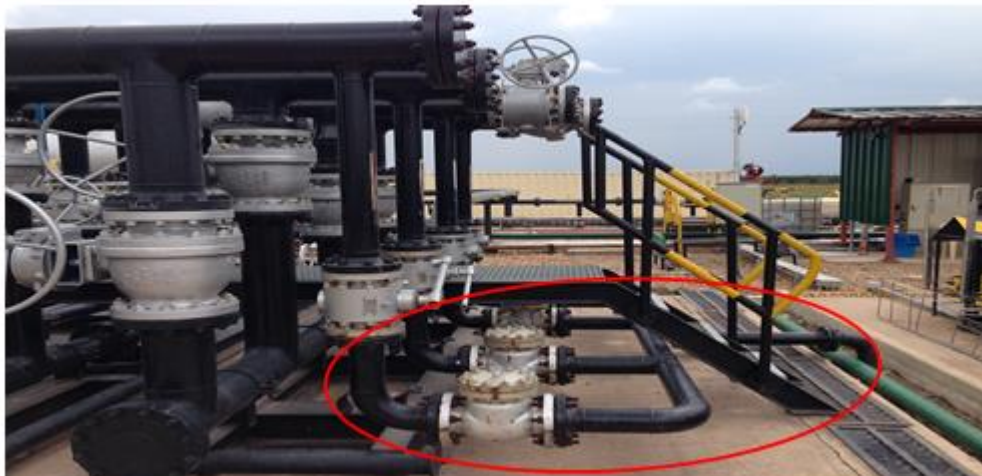
Fotografía 5. Línea de inyección de crudo liviano
