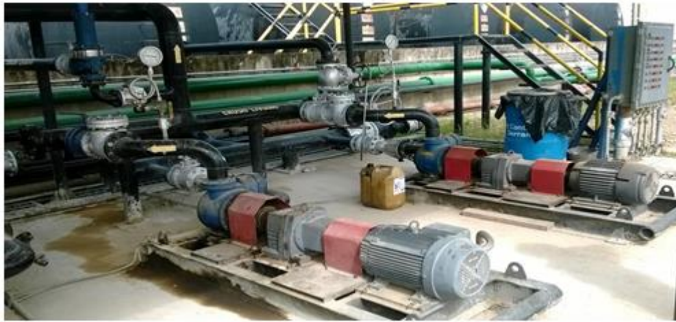
Fotografía 4. Bombas para inyectar el crudo liviano en el Manifold general
