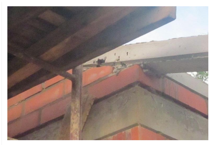
Figura 38. Discontinuidades del Concreto
