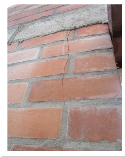
Figura 37. Fisuras Superficiales Muro
