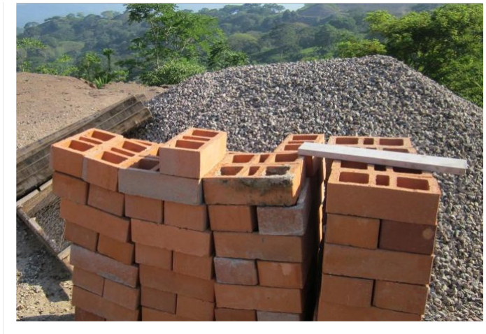
Figura 33. Ladrillos mal almacenados
