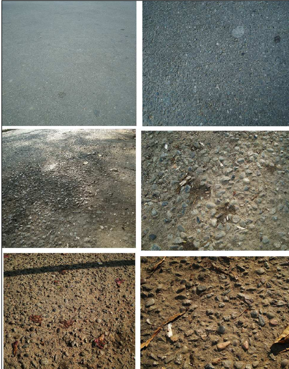
Figura 4. Evolución de la pérdida de agregado en pavimentos flexibles.
