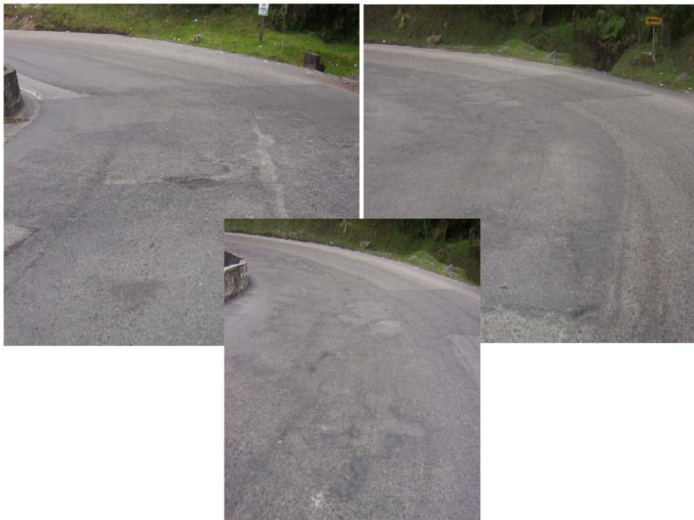
Figura 3. Pérdida de agregados.
