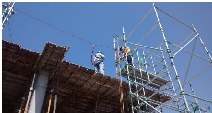
Figura 11. Inspección de placa con los elementos de protección personal y en alturas.
