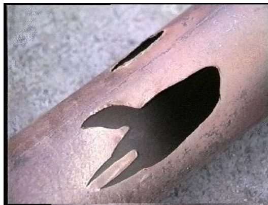
Figura 2. Tubería desgastada por el paso de material
