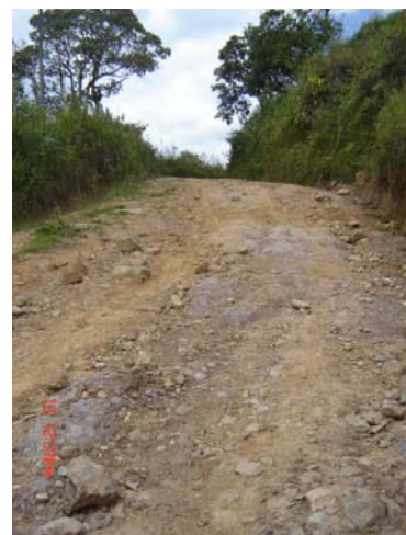
Figura 6. Deterioro De La Via
