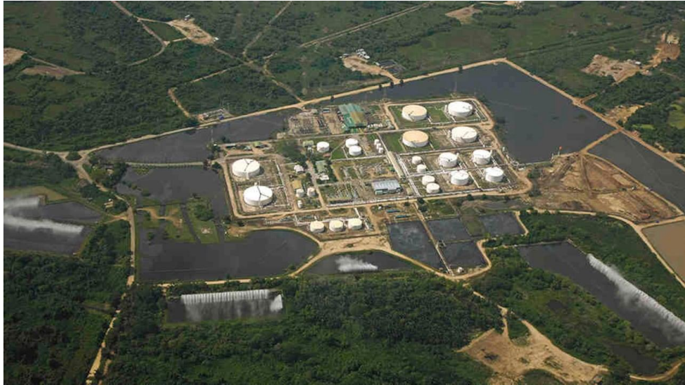
Figura 4. Espacio ocupado en superficie por el agua almacenada en el campo Caño Limón
