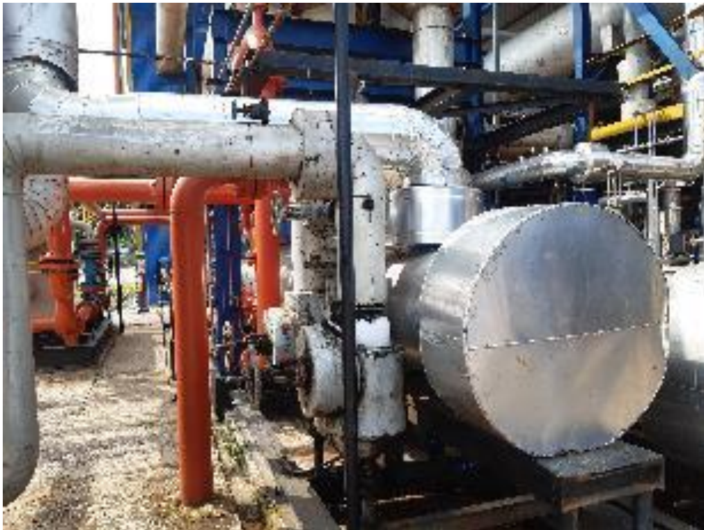
Vista lateral Intercambiador de Calor Planta de Gas Payoa
